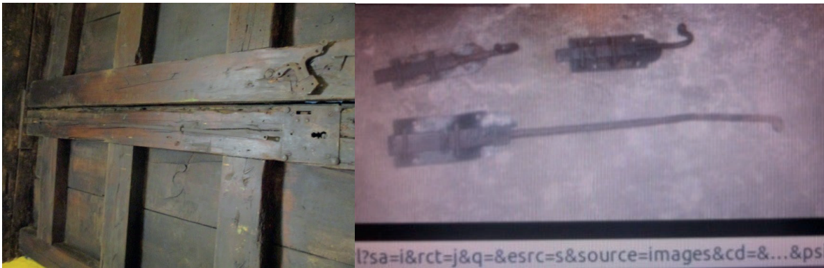
Figura 89. Una falleba colocada en la parte interna de la puerta de la Calle de Roldán.
