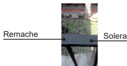
Figura 69. Detalles del segundo tipo de barandal en los pasillos interiores en Casa Talavera.
