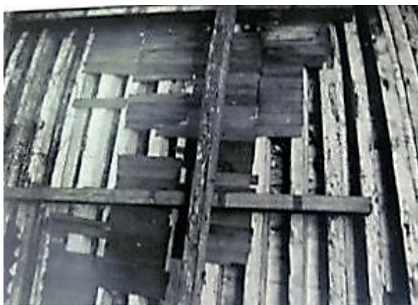
Figura 26. En la que se aprecia el mal estado de conservación en el que se encontraba el techo de las bodegas de Casa Talavera, ubicada en República de Salvador No.191. Fuente: Fotos de la inspección de 1970 (ACNMH, 1970).
