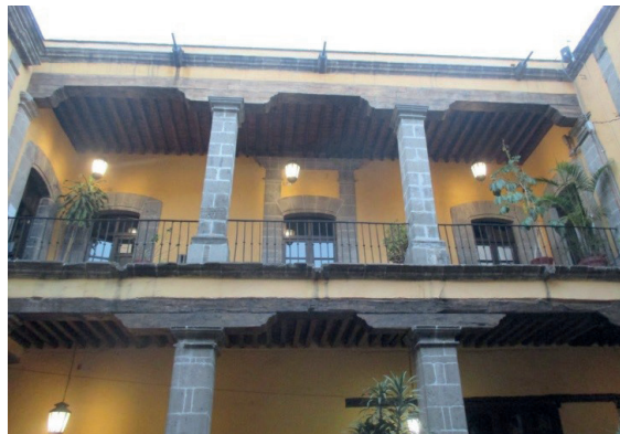
Figura 102 Conclusión de los trabajos de restauración en las pilas ubicadas al oeste del primer patio en ambos niveles de la Casa Talavera.
