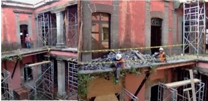
Figura 104. Se retiró el pasillo con su barandal del lado sur que no formaba parte de la obra original del edificio.
